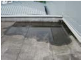
不陸による水溜まり
