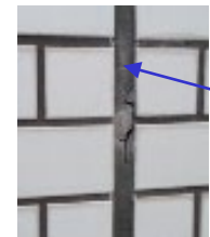
目地ひび割れ
