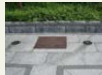
水道メーターボックス (親メーター)
