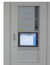
中央監視装置
