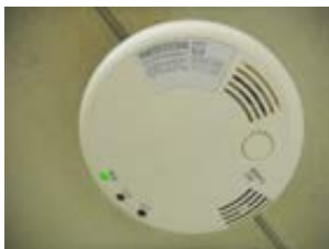
ガス漏れ警報器
