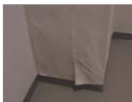
仕上げ材の剥がれ
