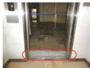
エレベーター扉の段差※12
