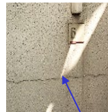
仕上げ材のひび割れ
