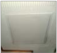
排煙口（通常閉鎖）
