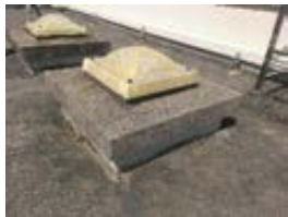
経年劣化したトップライト
