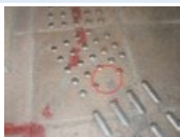
誘導鋲の欠損❖ 4
