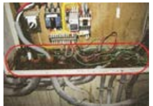
盤の腐食と変色◆7
