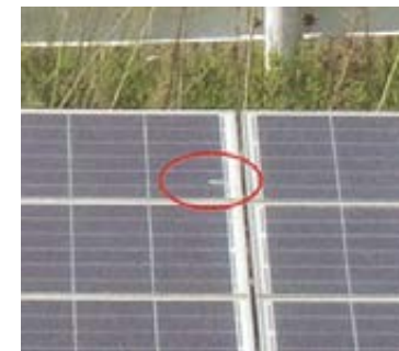
太陽光パネルの損傷❖9
