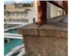
支柱部付近の損傷
