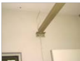
壁のひび割れ
