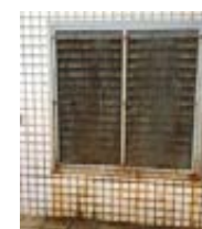
吸入口の腐食
