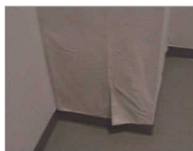
仕上げ材の剥がれ
