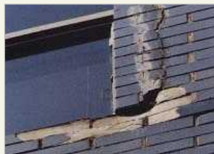
タイルの浮き・割れ
