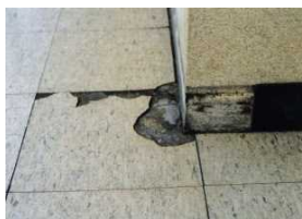
床仕上げ材の剥がれ
