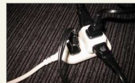
電気器具のつなぎすぎ
