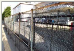
フェンスのさび
