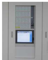
中央監視装置
