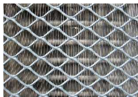
室外機フィン
