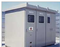
屋外型キュービクル （屋上及び屋外設置）
