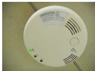
ガス漏れ警報器
