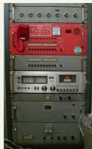
非常放送用アンプ
