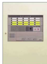
自動火災報知設備受信機
