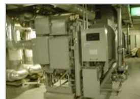
冷温水発生機
