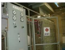
開放型電気室
