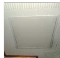
排煙口（通常閉鎖）
