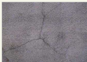
モルタルのひび割れ
