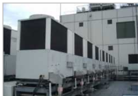
個別空調室外機
